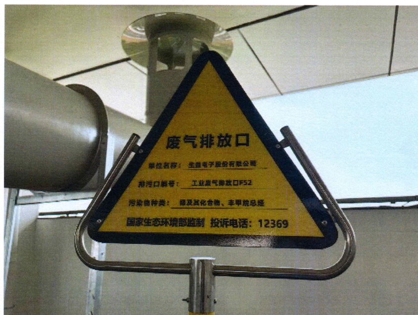
废气治理设施
